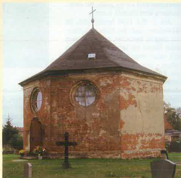
Dringender Sanierungsbedarf: Dorfkirche Glienicke (Lkrs. Ostprignitz-Ruppin)
